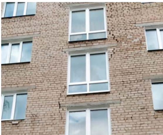
Рис. 2. Трещины на здании по состоянию на 12.05.2022 г.
