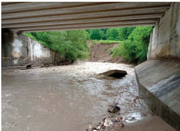
Рис. 2. Железобетонная плита, разрушенная паводком
