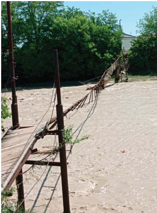
Рис. 4. Разрушенный пешеходный мост через р. Нальчик
