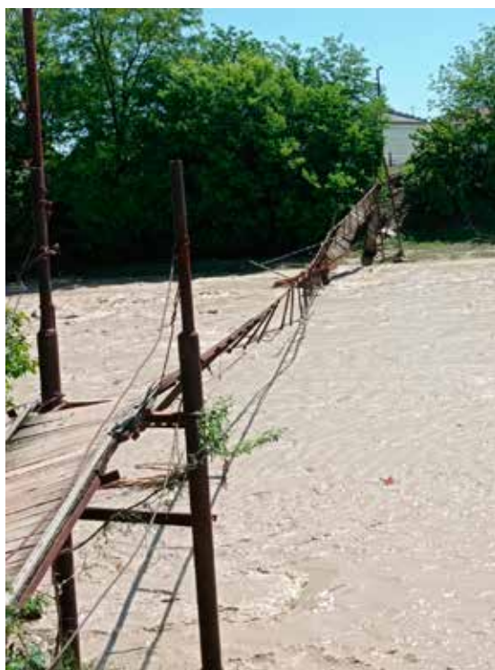
Рис. 4. Разрушенный пешеходный мост через р. Нальчик
