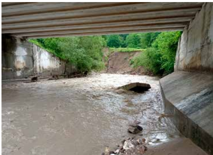
Рис. 2. Железобетонная плита, разрушенная паводком
